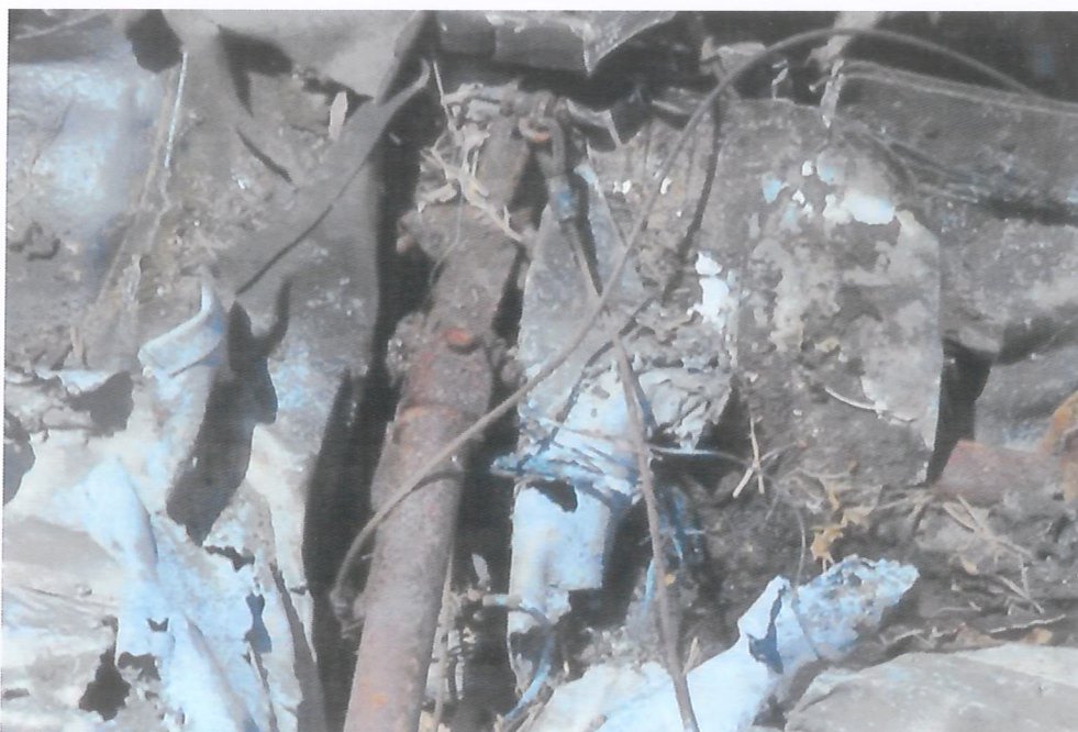
Φωτ. 11: Ακροσύνδεσμοι συνδεσμολογίας "Elevator" στο ύψος του χειριστηρίου
