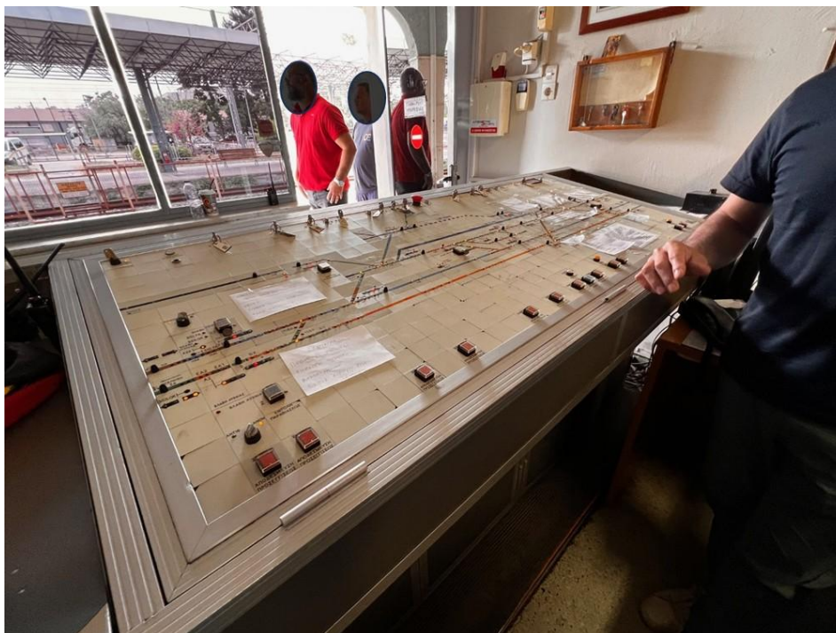
Εικόνα 37. Ο πίνακας ελέγχου στο σταθμό Λάρισας.
